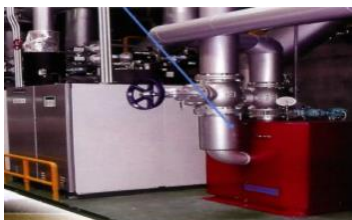
蒸気ボイラーのドレン削減
