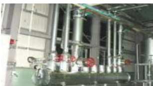
配水管の腐食・ スケール対策、 延命化策・修繕費削減策
