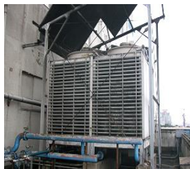
冷却塔の浄化・ スケール対策
